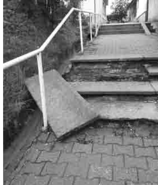
Schody z Rynku na Równię wymagają remontu
